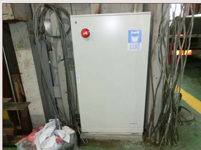
工場パッケージ型消防設備の設置後。
