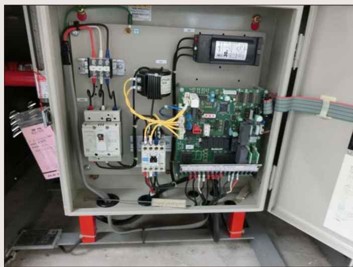
支援施設でホームスプリンクラー設備の制御盤から警報盤への配線後。
