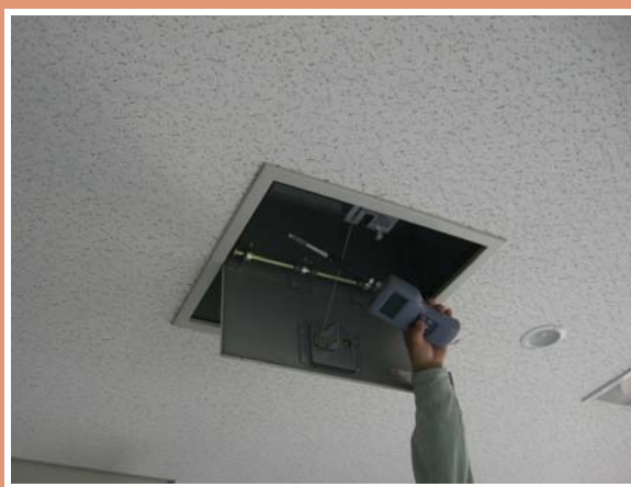
機械排煙設備排煙口
