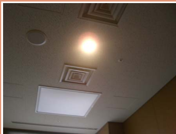
非常用照明設備点灯中 (2)
