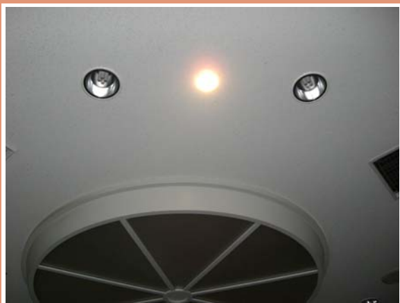
非常用照明設備点灯中 (1)
