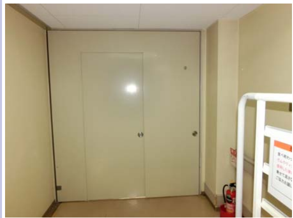
防火戸閉鎖後
