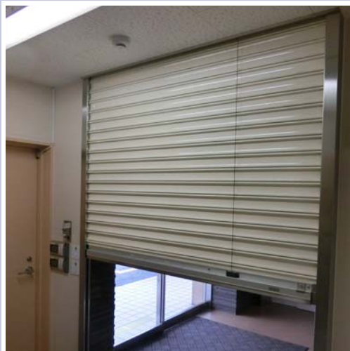
防火シャッター危害防止装置作動中
